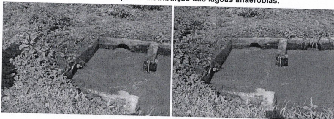
Figura 47 - Tanque de distribuição das lagoas anaeróbias.
