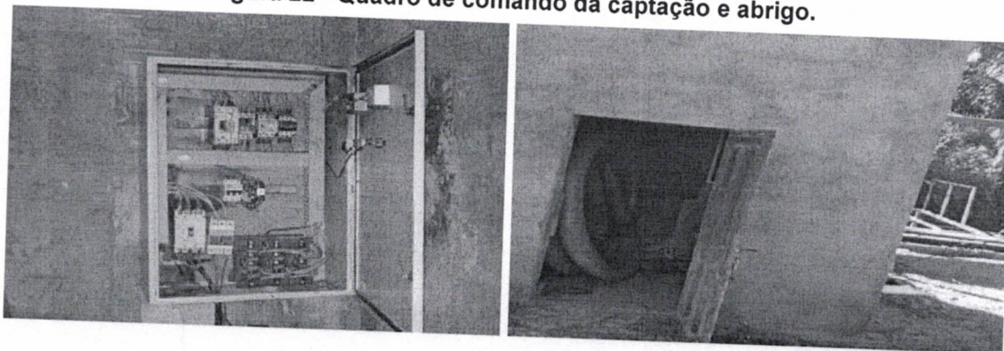
Figura 22 - Quadro de comando da captação e abrigo.
